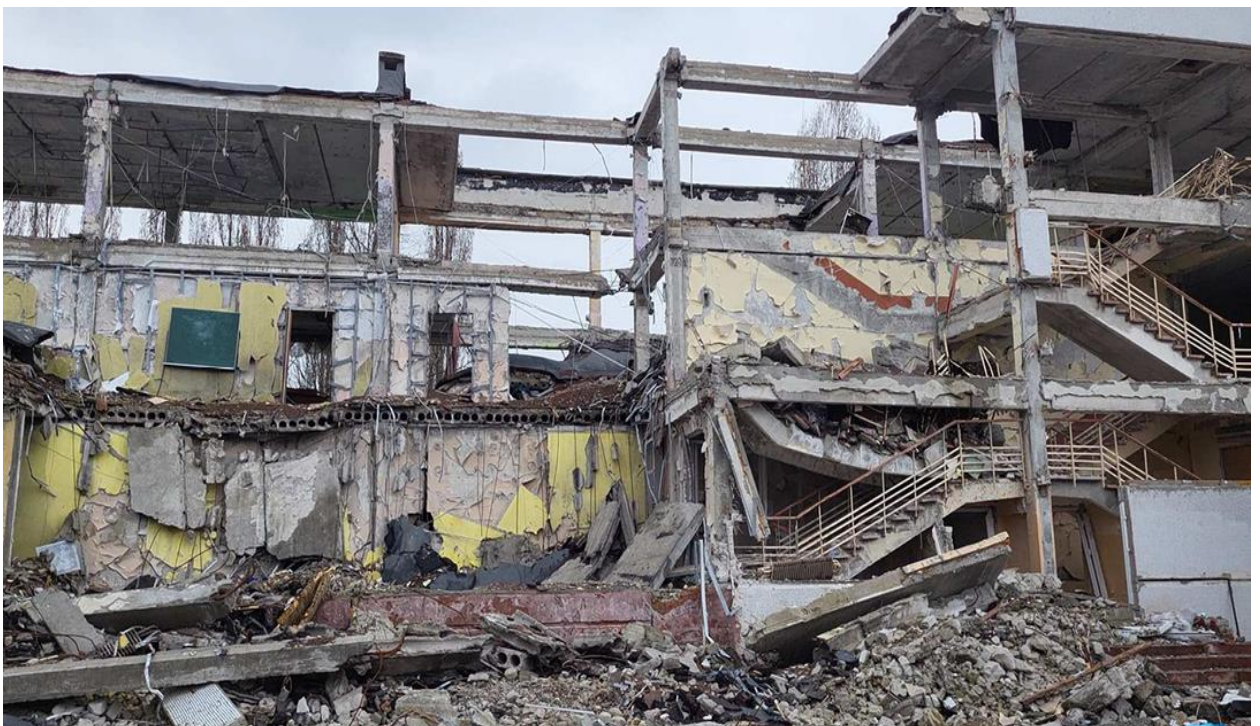
Рисунок 18, 19 — Фотофіксація пошкоджень під час обстеження стану об'єкта
