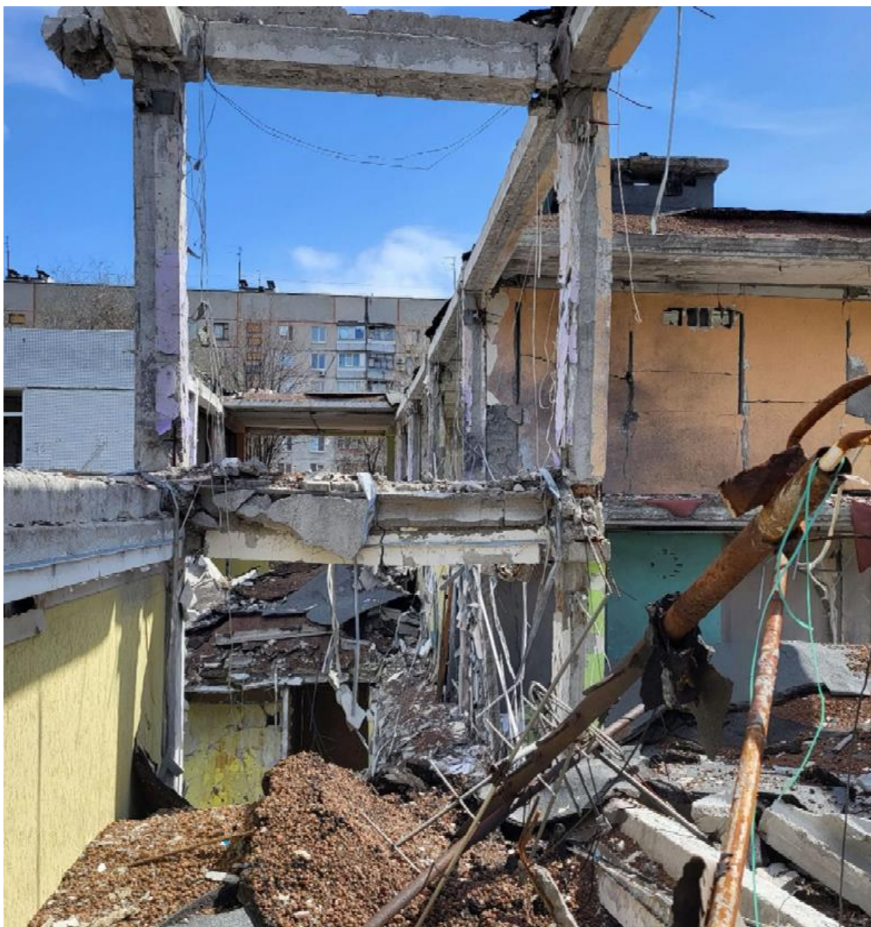
Рисунок 17 — Фотофіксація пошкоджень під час обстеження стану об'єкта
