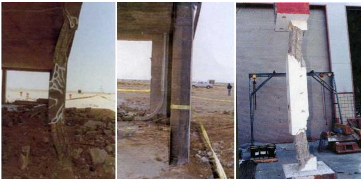
Рисунок 5 — Вид колон після вибухового впливу: 1) колона, не посилена вуглепластиком; 2) колона, посилена вуглепластиком; 3) колона без посилення після випробувань у лабораторії
