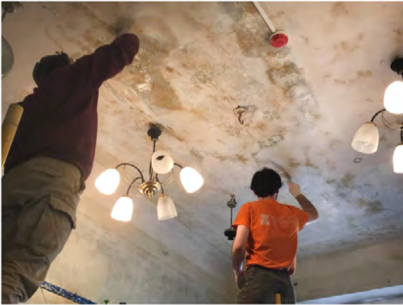
Фото 5. Замокання стелі у процесі побуту
