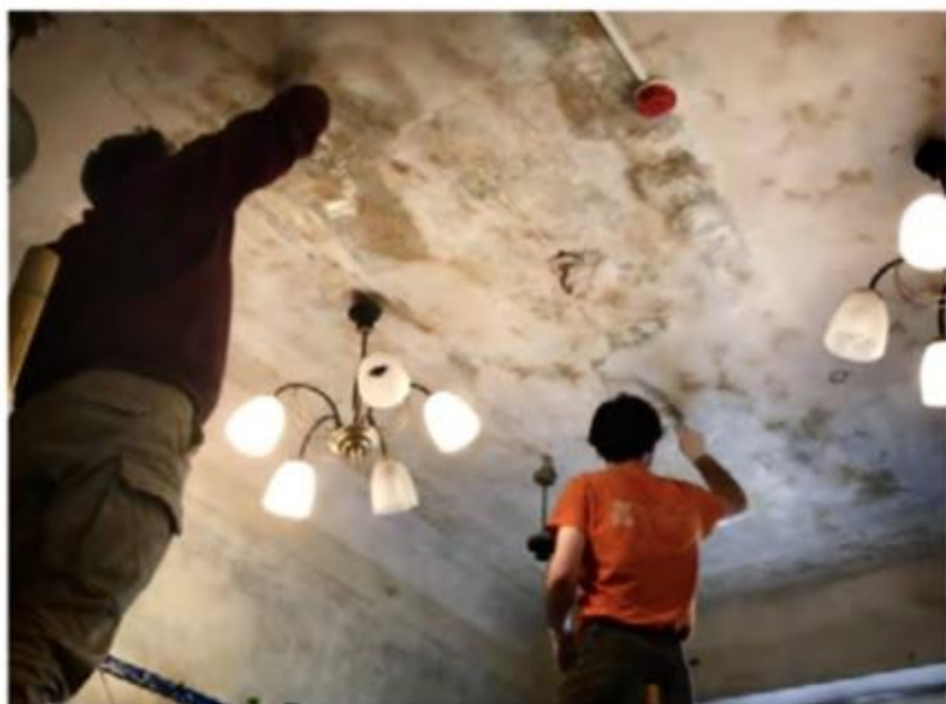
Фото 5. Замокання стелі у процесі побуту
